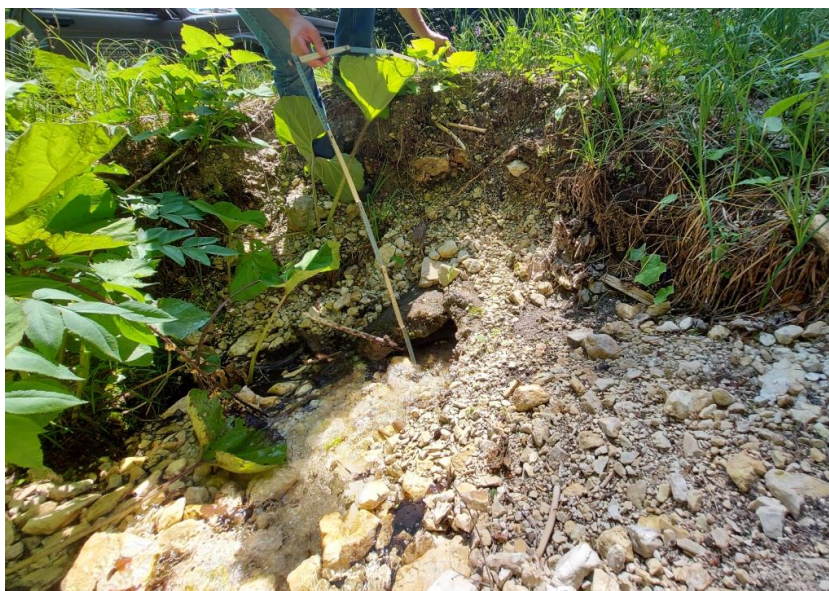
Slika 15: Propust \varnothing 100 gotovo u potpunosti zatrpan nanesenim materijalom, protok vode otežan (Čaluk, 2022)
