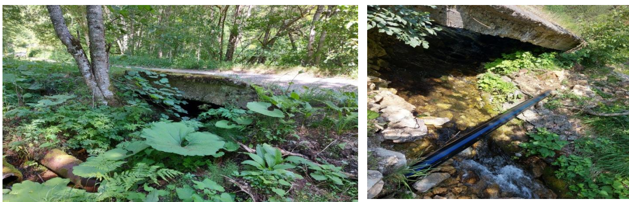
Slika 22: Vodovodne cijevi u koritu rijeke
