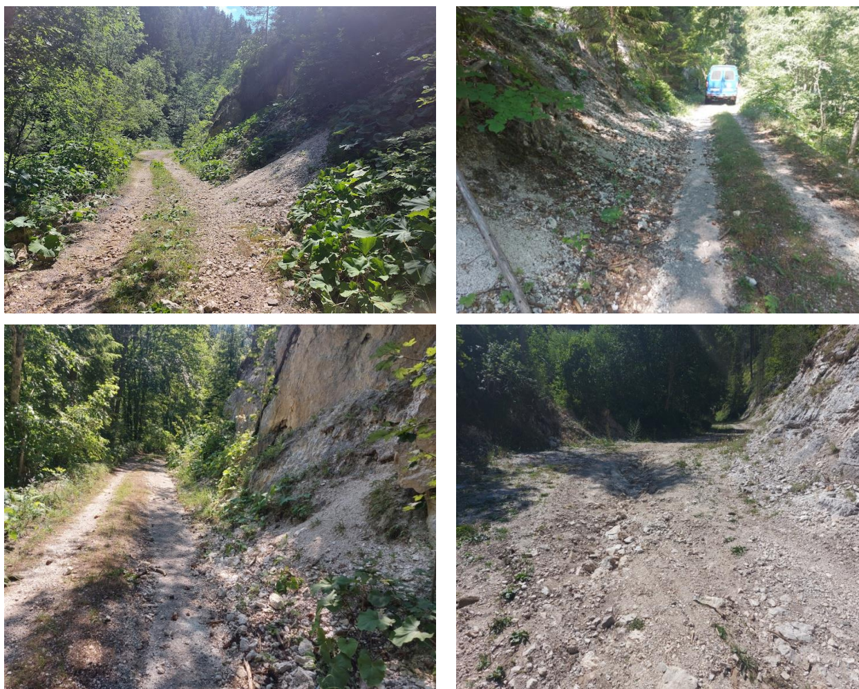
Slika 5: Odroni na šumskom kamionskom putu kao rezultat nepravilno izvedene kosine usjeka (Čaluk, 2022)
