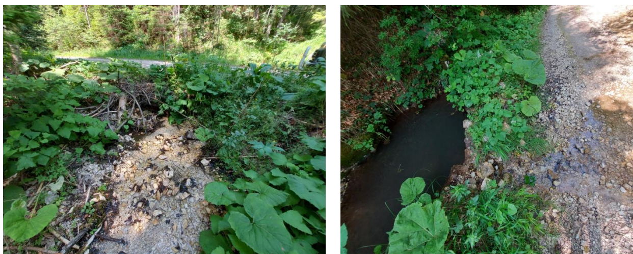
Slika 13: Primjer oštećenog propusta koji nije funkcionalan
